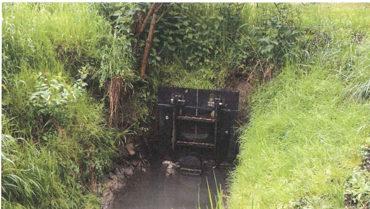
Istniejący wylot z komory rozdziału z klapą zwrotną ( kłapa do likwidacji)
