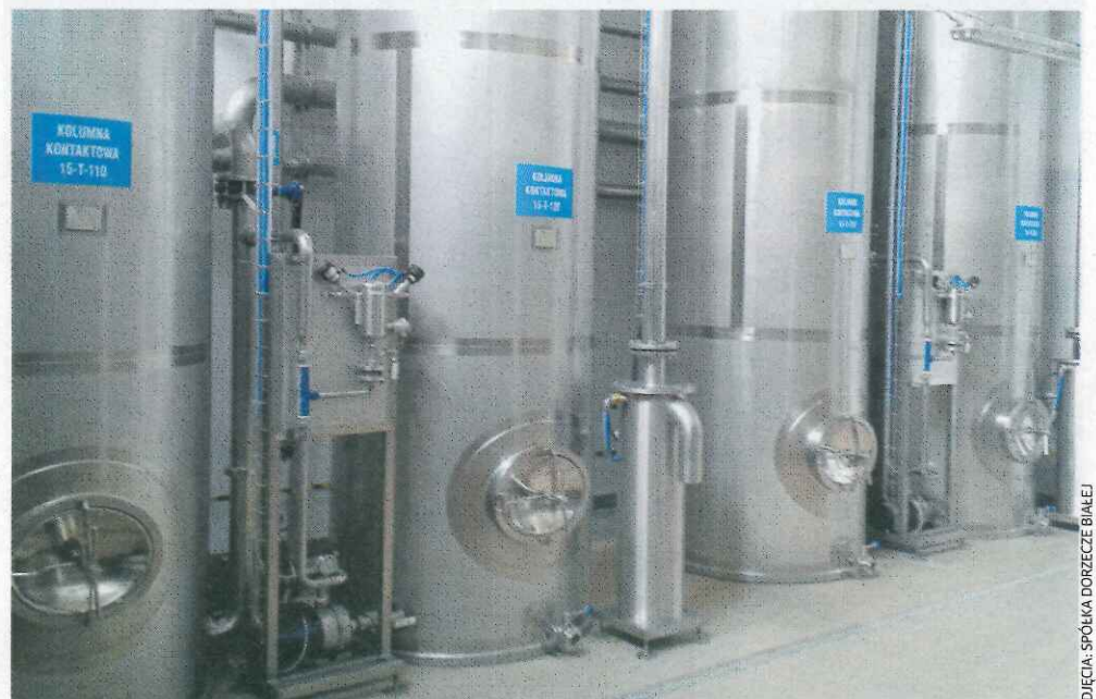
Hala kolumn kontaktowych stacji uzdatniania wody w Lubaszowej
