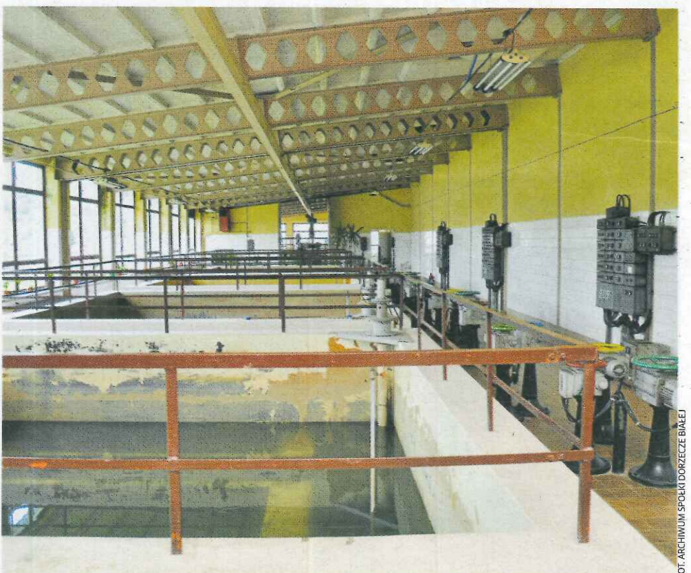
...i hala filtrów stacji uzdatniania wody w Lubaszowej
