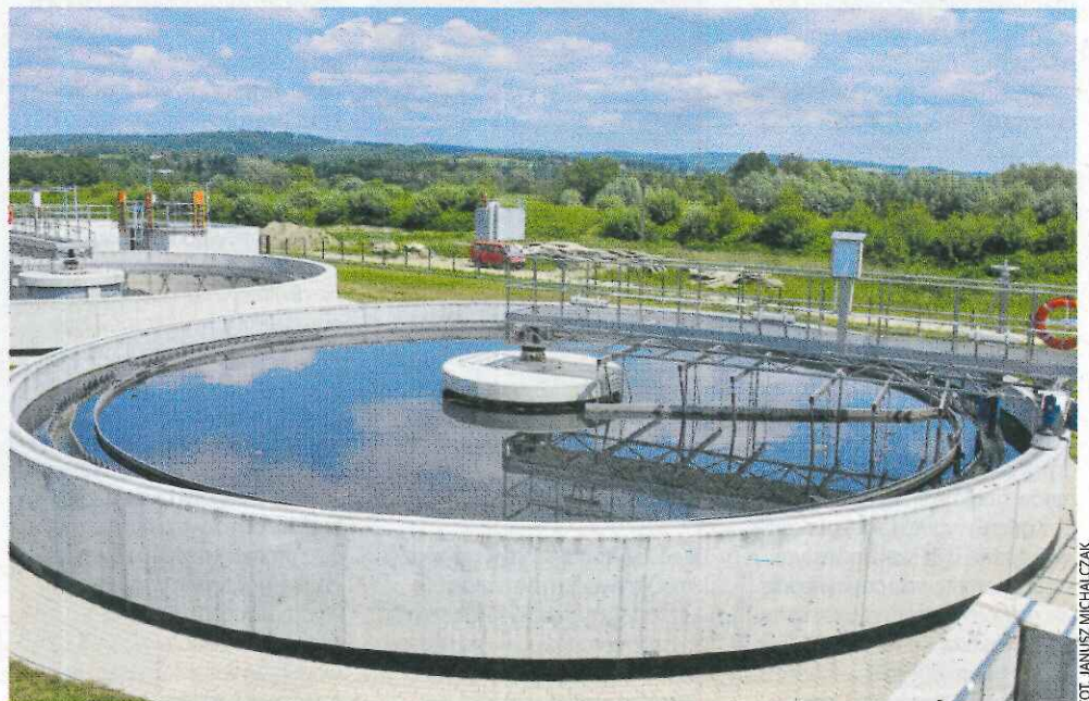
Osadnik wtórny, oczyszczalnia ścieków w Tuchowie
