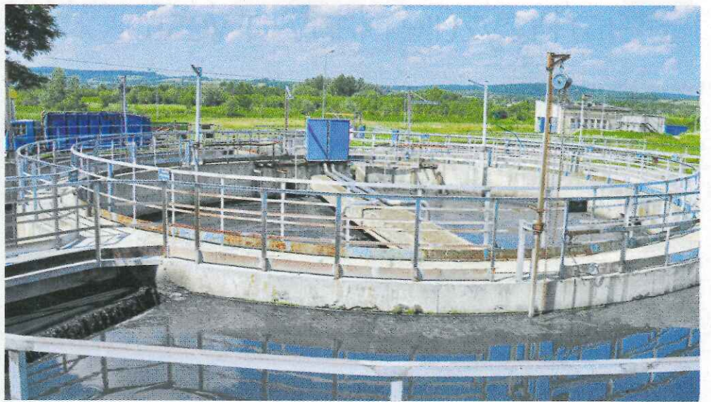
Reaktor biologiczny oczyszczalni ścieków w Tuchowie
