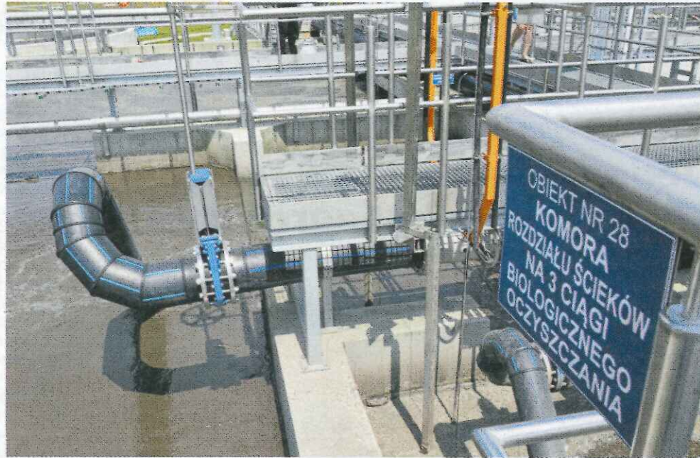
Fragment instalacji komory oczyszczania ścieków w Tuchowie
