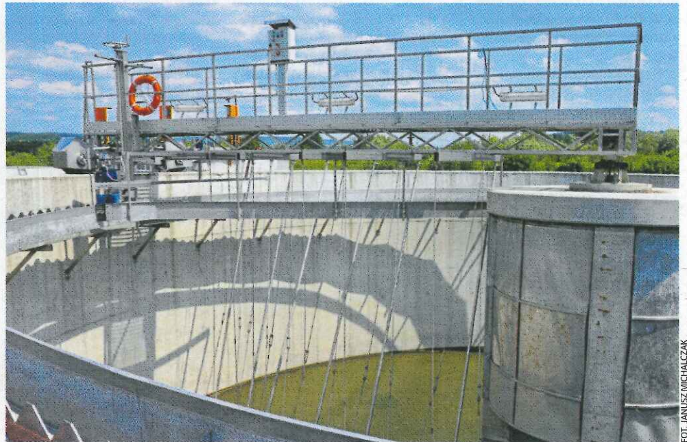
Osadnik wtórny (przed napełnieniem), oczyszczalnia ścieków w Tuchowie
